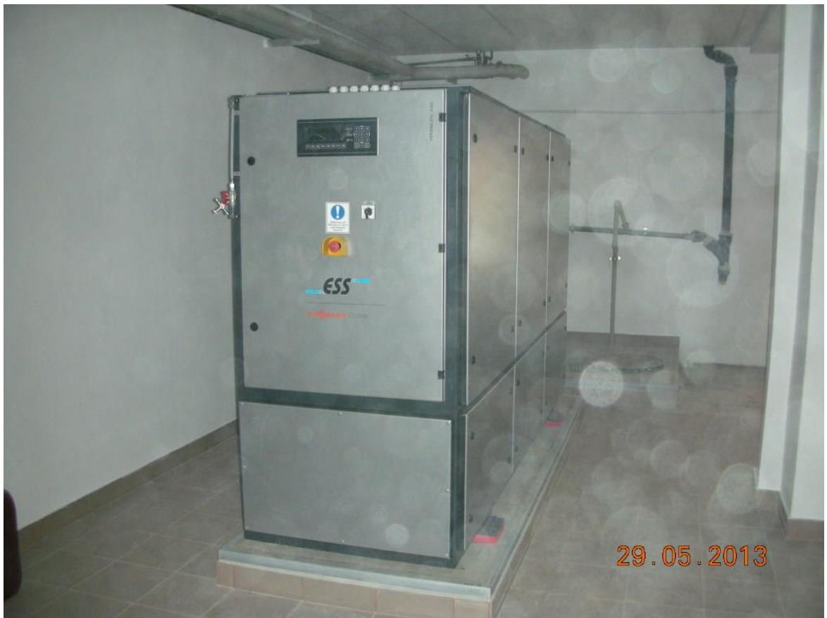
Agregat kogeneracyjny 55kW
